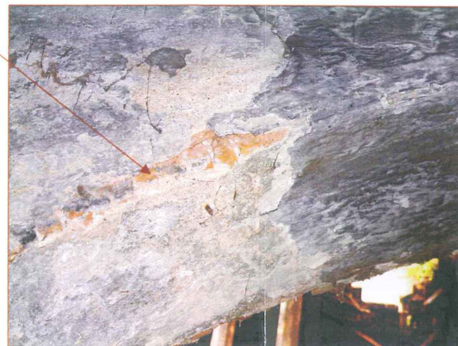
Detall de l'arc. Hom pot distingir el maó massís disposat a plec de llibre així com el junt amb el morter de calç
