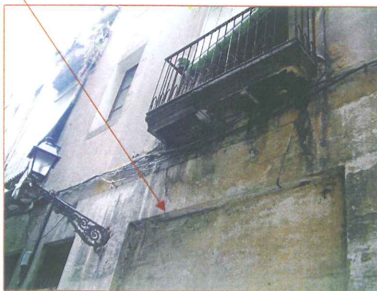
Vista parcial de la planta baixa de la façana més oriental de la finca. Podem distingir l'acabat petri dels elements que defineixen les obertures
