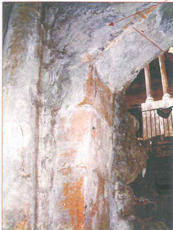
Detall de la pilastra sobre la que imposta l'arc rebaixat del costat més nord-est del pati. Podem distingir la seva configuració amb carreus de gres de Montjuïc i la fesomia del lliurament de l'arc
